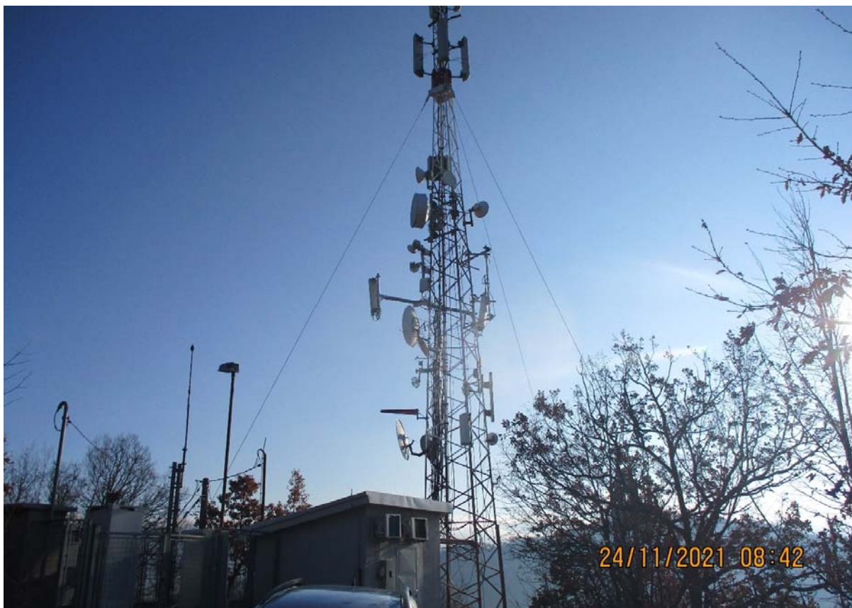
Slika 3: Prikaz stuba na kom se nalazi Cetin bazna stanica Prijepolje
