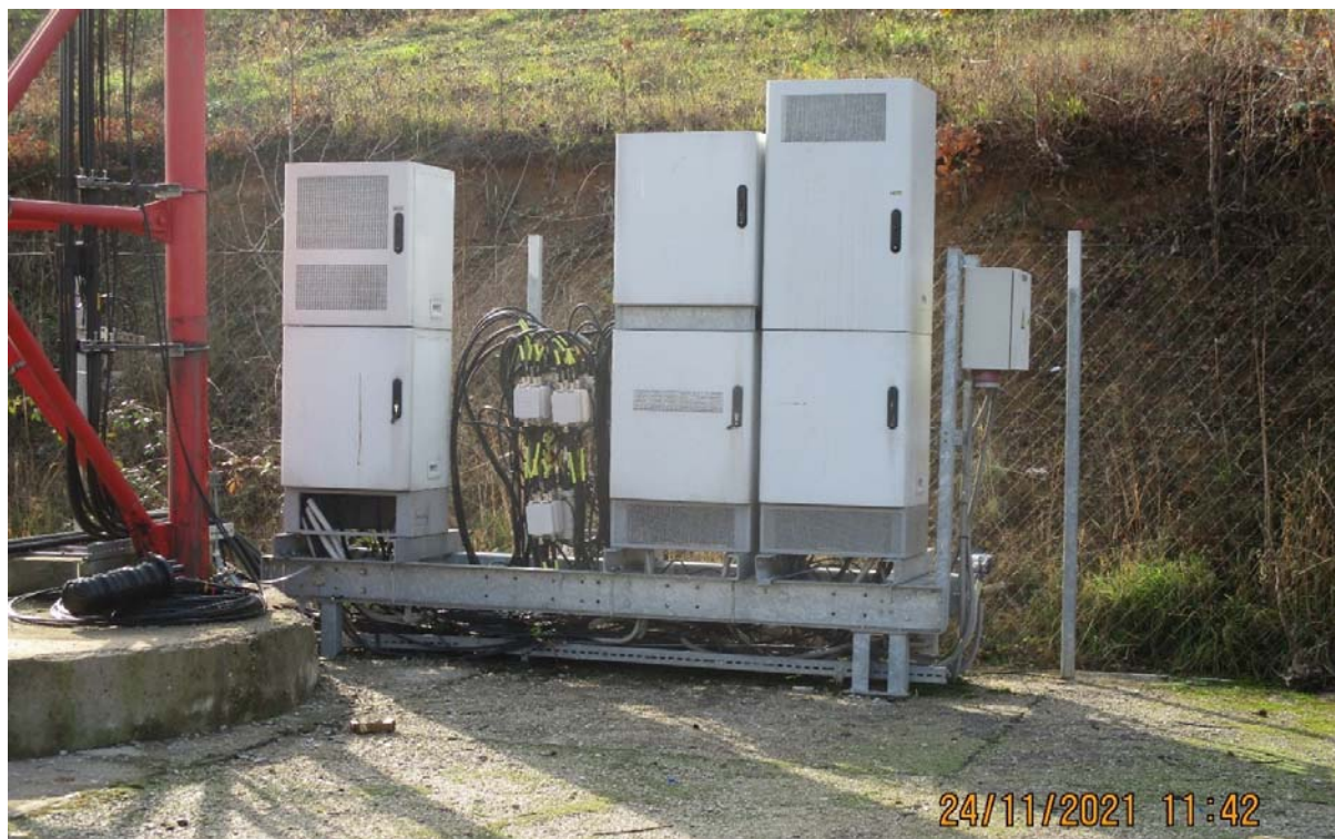
Slika 4: Kabineti bazne stanice Cetin BS Prijepolje 3
